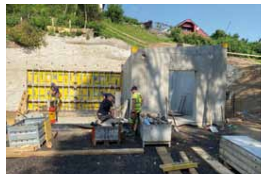
Pumpwerk 2 in der Murstraße.
